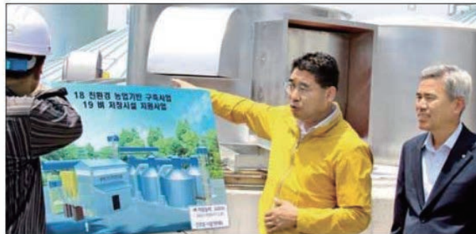
허순구 전남 광양농협 조합장(오른쪽 두번째)이 광양읍 세풍리의 벼 저장시설 공사현장을 살펴보고 있다.
